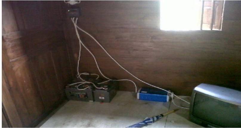
Instalasi Solar Cell Dalam Rumah
