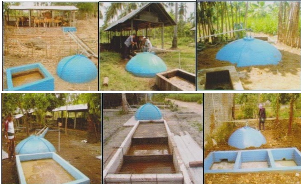
Instalasi Biogas Kotoran Ternak Sapi
