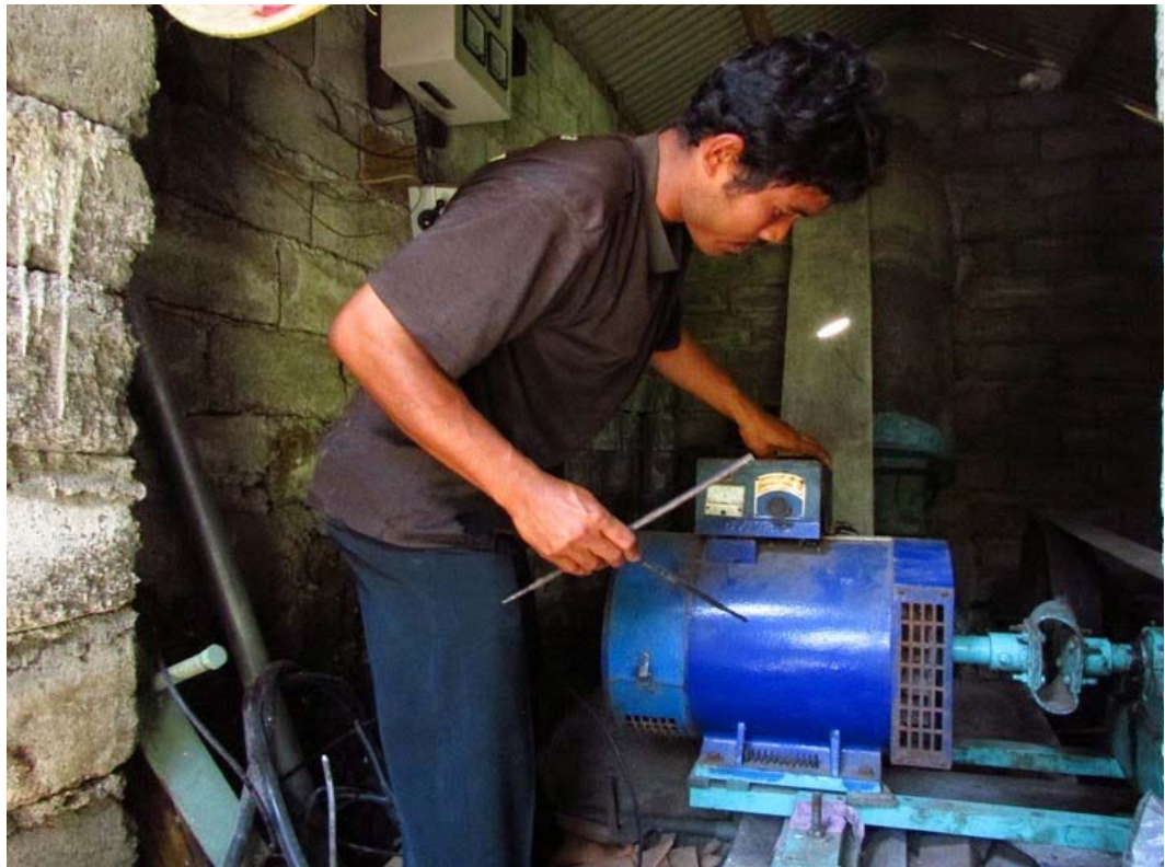
Pemeliharaan Instalasi Sumber Energi Listrik
