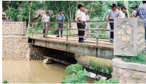
Gelagar baja korosi karena tidak dicat
