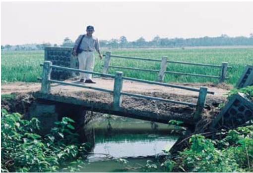
Beban merusak jembatan beton
