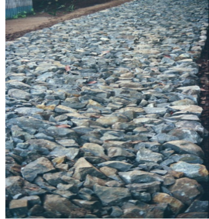
Jalan telford sebelum ada lapisan atas
