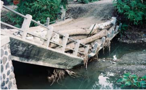
Fondasi turun di jembatan kecil
