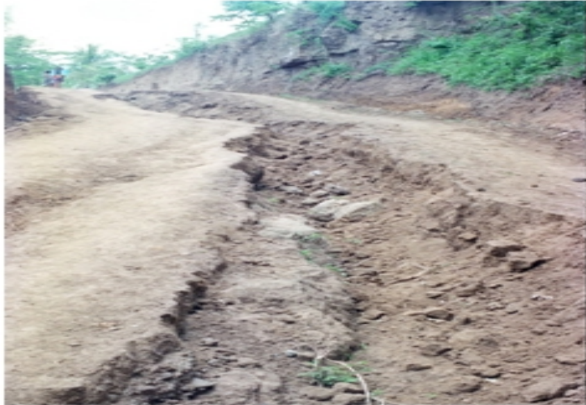
Erosi besar di tengah tanjakan
