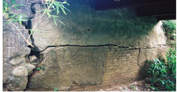
Abutmen jalan retak
