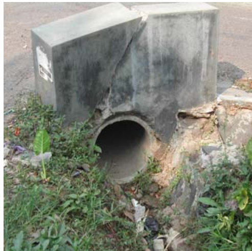
Gorong-gorong buis beton, tetapi lapisan tanah atas terlalu tipis
