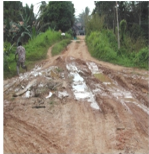
Jalan selalu becek karena drainase tidak berfungsi
