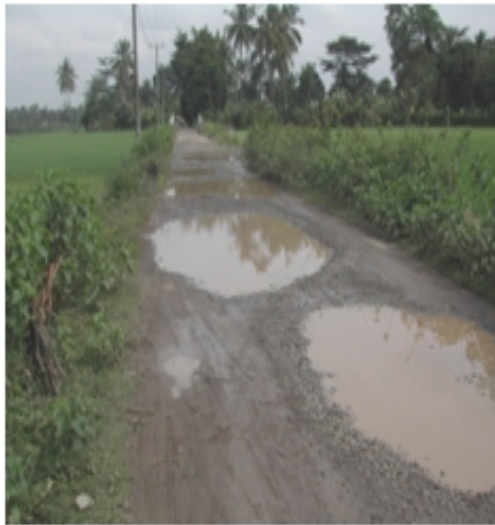
Air tergenang di jalan karena badan jalan tidak punggung sapi
