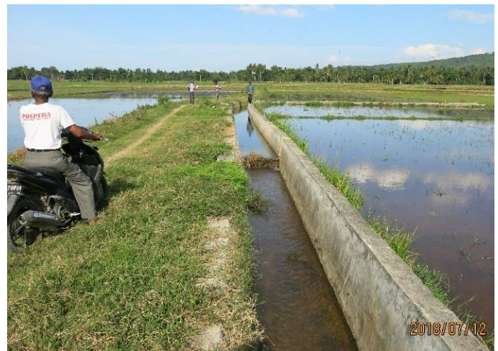
Saluran irigasi di desa Manyang Lancok dengan desain yang tidak selesai dan pemeliharaan yang tidak baik. Saluran ini tidak memiliki pintu air. Masyarakat tidak melakukan pemeliharaan dasar seperti pembersihan tanaman liar. (Bank Dunia, 2018)
